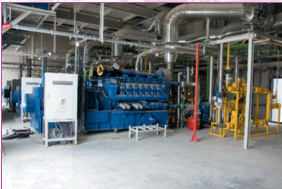
Central de biogás en PTR (Zaragoza).
