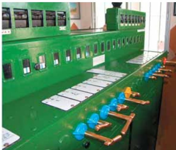
Mesa de enclavamiento de Cariñena
