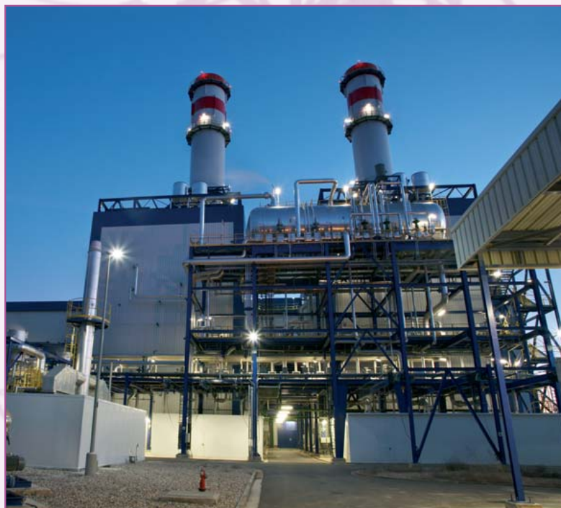
Central de ciclo combinado "Castelnou" de 790 MW
