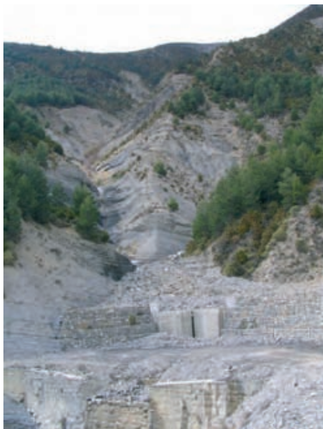
Erosiones y dique de protección y defensa de la pista de acceso a Cajol en la Sola de Bargasé.
