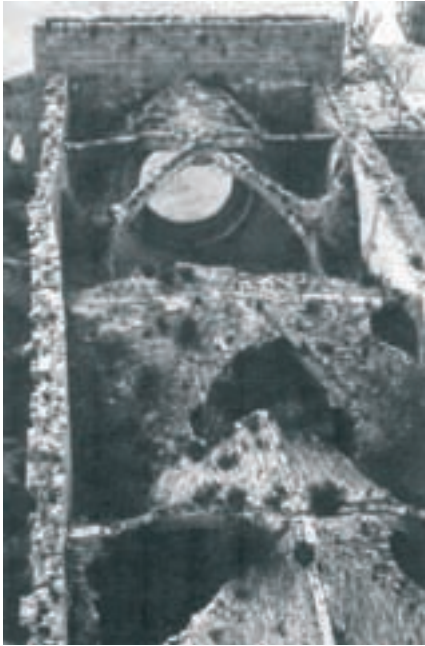
Bóvedas arruinadas de la iglesia. Foto de Raphaël Vaubourgoin.
