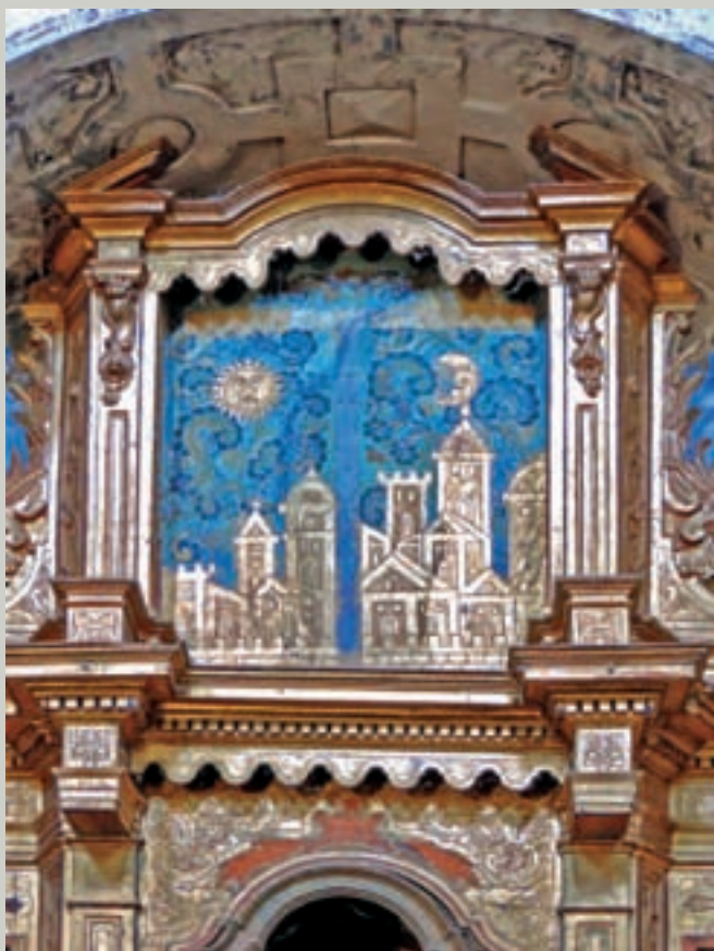
Detalles de los retablos laterales. Se puede apreciar el penoso estado en el que se encuentran.
