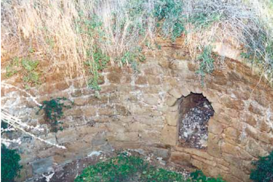
Peralta de la Sal. Paredes de buena factura y bóveda de ladrillo derruida.
