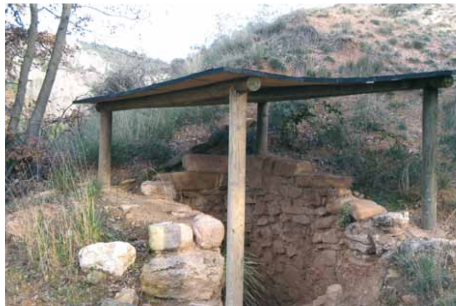
Getsemaní I. Cubierta instalada recientemente para evitar que el agua llegue al interior.
