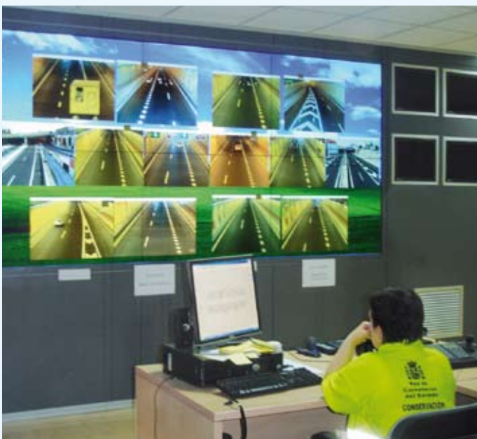
Operador en el centro de control del ministerio de Fomento vigilando el funcionamiento de los equipos del túnel de Santa Isabel.
