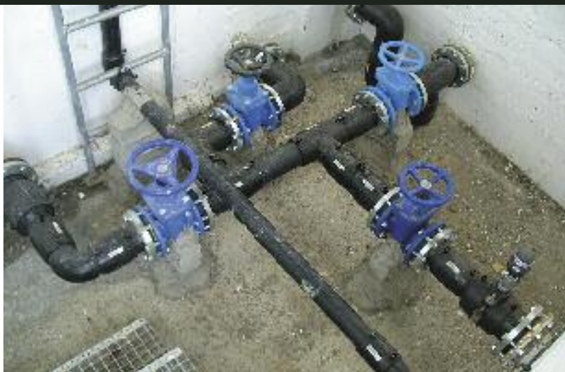
Redes de distribución de agua potable en Loporzano (Huesca) Foto: CINGRAL, S.L.
