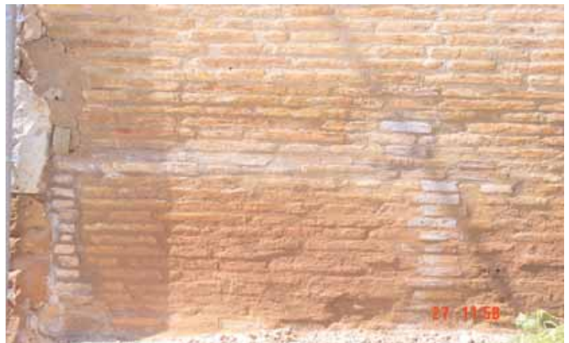
Eflorescencias del ábside.
