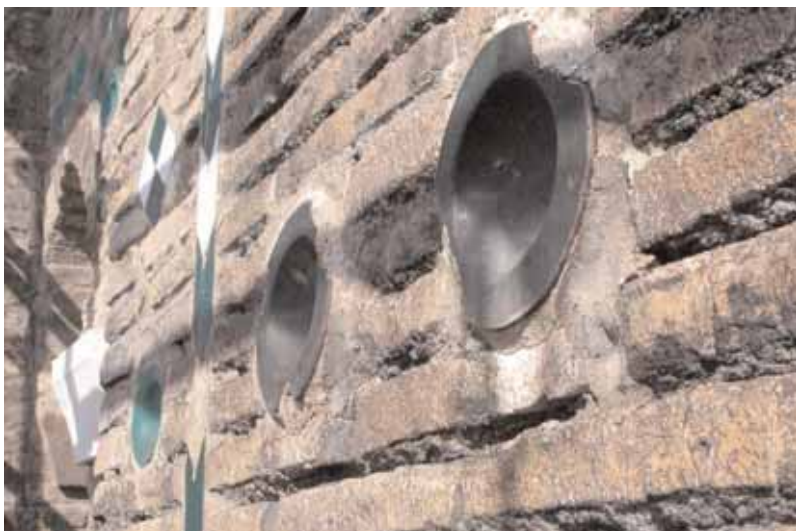
Detalle del estado de conservación de la decoración cerámica en la iglesia de la Madalena de Zaragoza.
