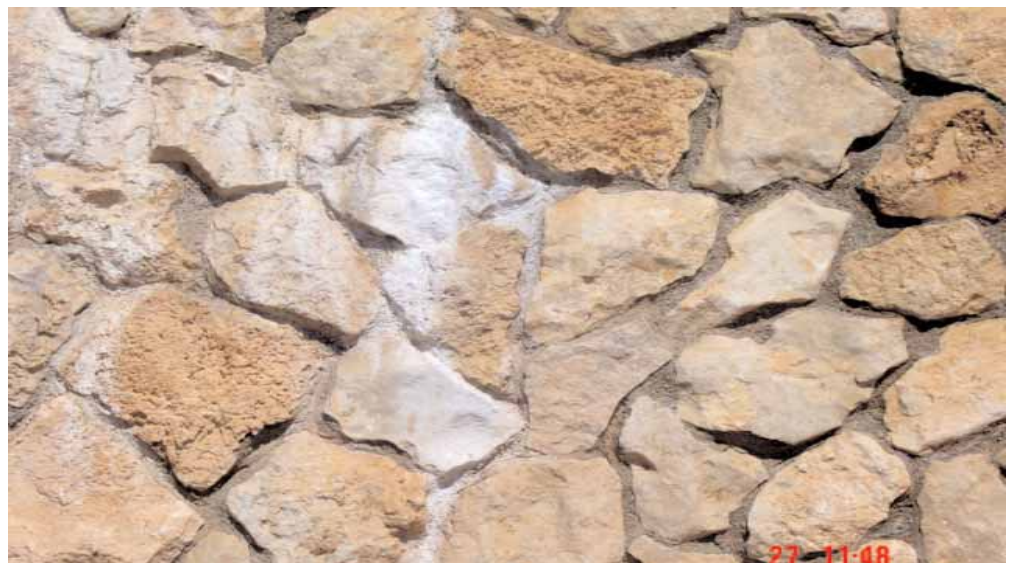
Eflorescencias del muro del parque.
