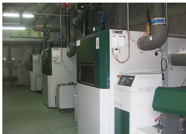
Calderas de biomasa 3 x 500 kW (Alagón, Zaragoza)
