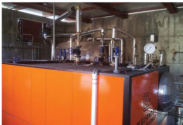
Caldera vapor con biomasa 1.395 kW (Villamayor, Zaragoza)
