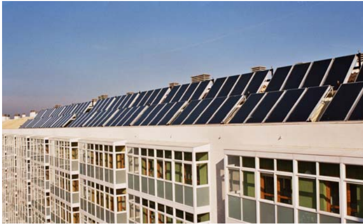
Instalación solar en Parque Goya (Zaragoza)
