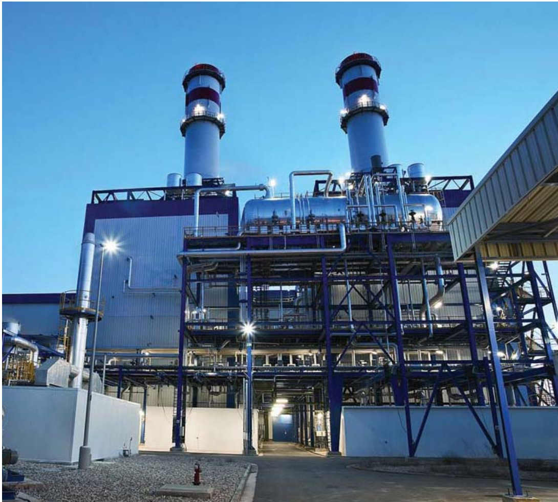
Central de ciclo combinado de 790 MW (Castelnou, Teruel)
