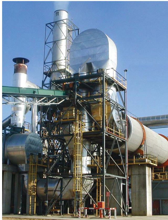
Central de cogeneración de 24,9 MW (Cella, Teruel)
