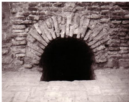
Torre del Homenaje. Desagüe.
