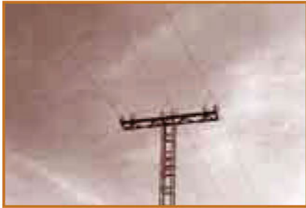
Tendido donde se electrocutó una pareja en mayo de este año
