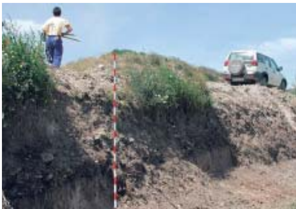
Limpieza arqueológica, realizada en abril de 2003, en el lateral de la vía romana en Gallur, que descubrió un espesor de 90 cm de afirmado con zahorras sobre el sustrato natural de arcillas
