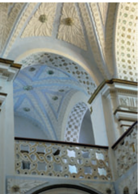
Tribuna lateral y parte del coro de la iglesia de Peralta con calados mudéjares y yeserías en bóvedas e intradoses de las arcadas
