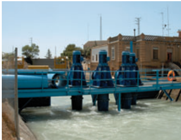
En los últimos años se han modernizado las instalaciones del canal: compuertas accionadas mediante paneles solares, sistemas informatizados y motores de bombeo para el riego con aguas procedentes del Noguera Ribagorzana. Foto de la casilla del canal en Tamarite
