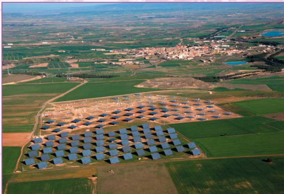
Instalación solar 1,5 MW (en ampliación a 4,5 MW) con seguidores de 25 kW. Sádaba (Zaragoza).
