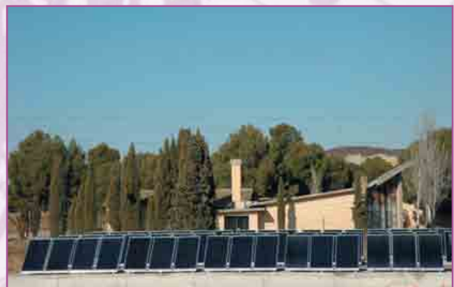
Instalación solar térmica en el Centro Atades. Zaragoza.
