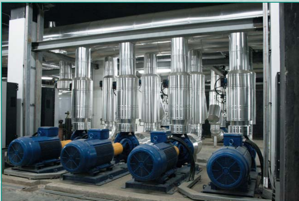
Instalaciones energéticas Expo 2008.
