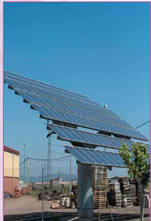
Instalación solar. Monreal del Campo (Teruel).
