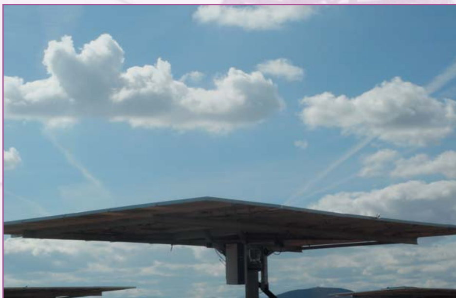
Instalación solar de 100 kW con seguidor a 2 ejes 5 kW. Fuentes Claras (Teruel).
