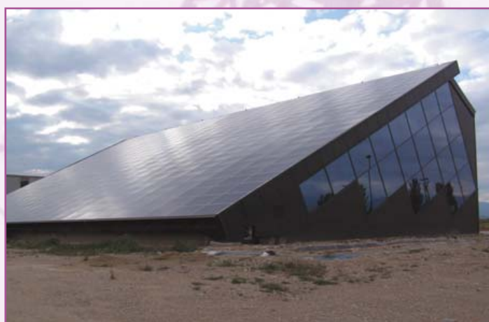
Instalación solar en cubierta 80 kW en Grupo OX-CTA. Walqa (Huesca).
