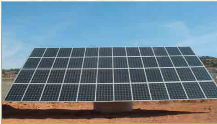
Instalación solar de 180 Kw con seguidor a 1 eje 10 kW. Calamocho (Teruel).
