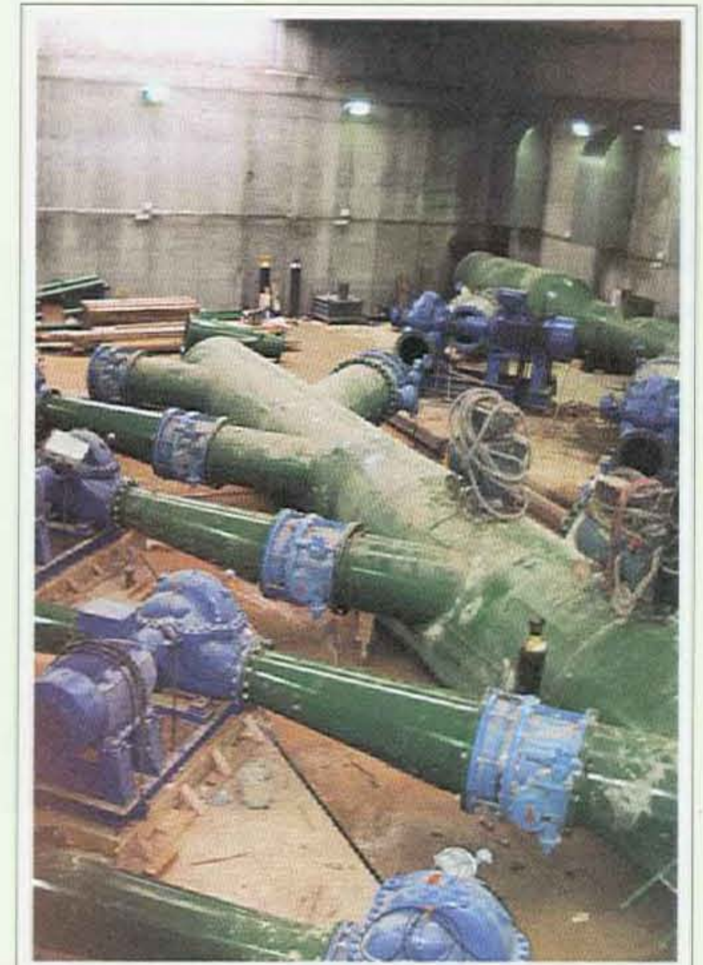
Estación de bombeo. Desde estas instalaciones se alimentan las dos balsas de riego.
