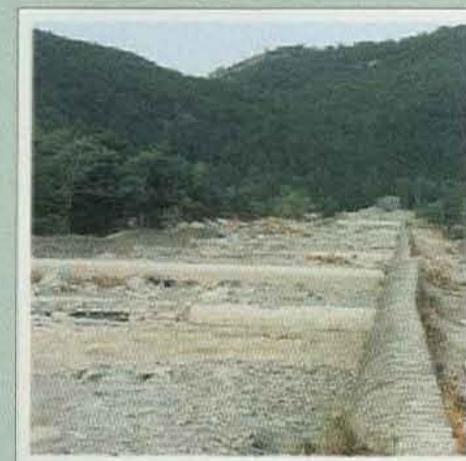
Deterioros. El encauzamiento tras la riada.
