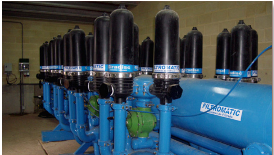
Foto 3: Interior estación de filtrado.
