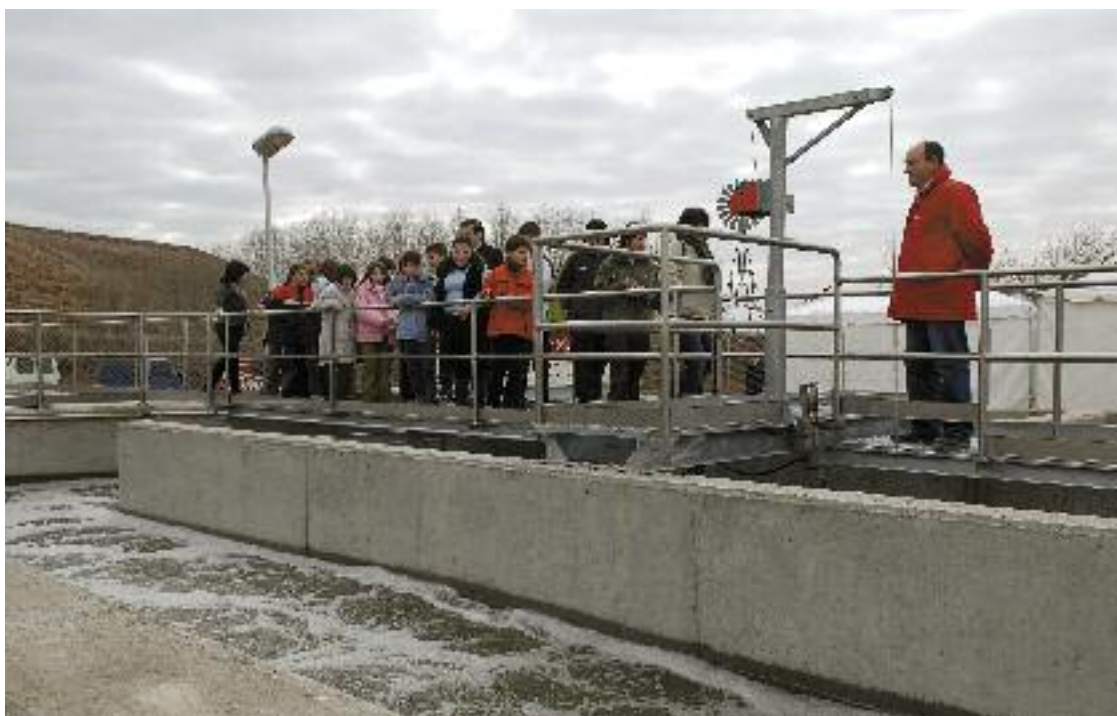
Instalaciones de la depuradora de Aniñón.
