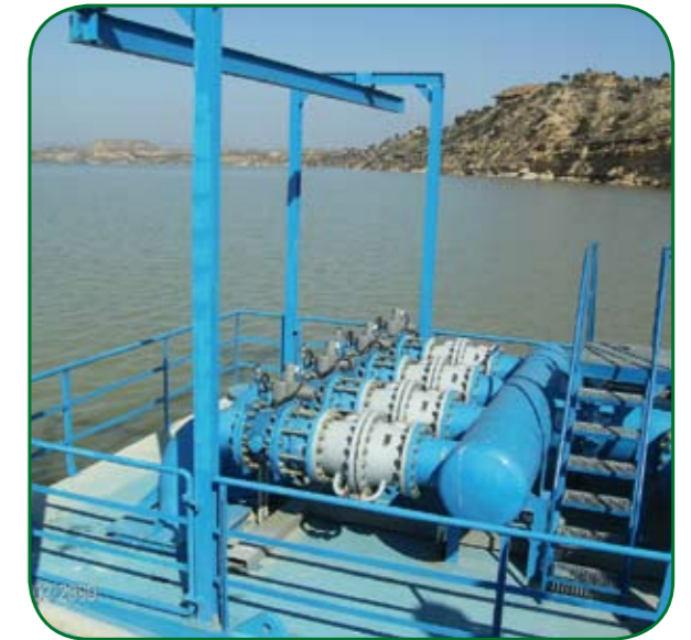
El objetivo de los proyectos es reducir el coste eléctrico de los bombeos.
