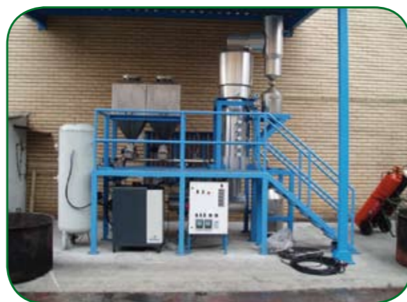
Planta piloto de pirólisis y gasificación.
