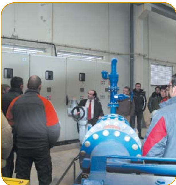
El telecontrol y automatización de equipos de bombeo permite ajustar los tiempos de riego.
