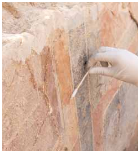
Limpieza de la capa superficial del muro de H6 mediante hisopo humedecido con agua-alcohol
