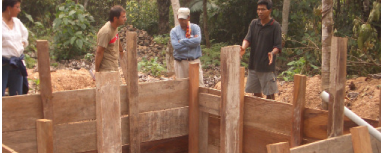
La población de Villa Alcira se implicó decididamente en el traslado de los materiales y construcción del tanque de almacenamiento". (Foto: Manuel Charlon)
