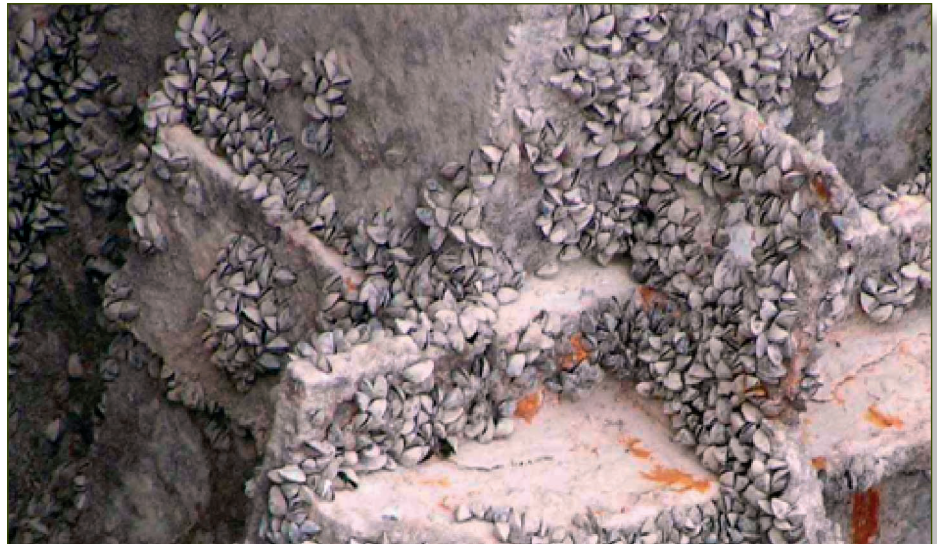
Foto 2: Detalle mejillón en estructura de elevación.
