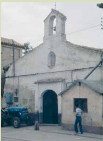
Ermita del Milagro, antes de la restauración.
