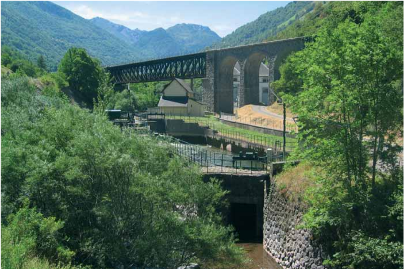
El soberbio viaducto metálico de Urdos (154 m). A pesar del tiempo transcurrido, la corrosión ha sido mínima (Foto: J. Suter).
