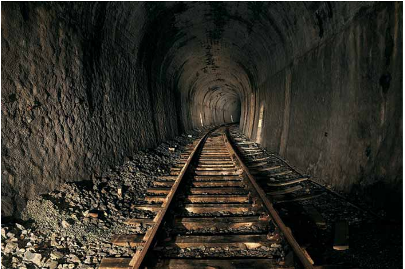
Interior del túnel de Broca, de 621 m de longitud, al norte de Cette-Eygun. Obsérvese su perfecta conservación (Foto: Railtrash).
