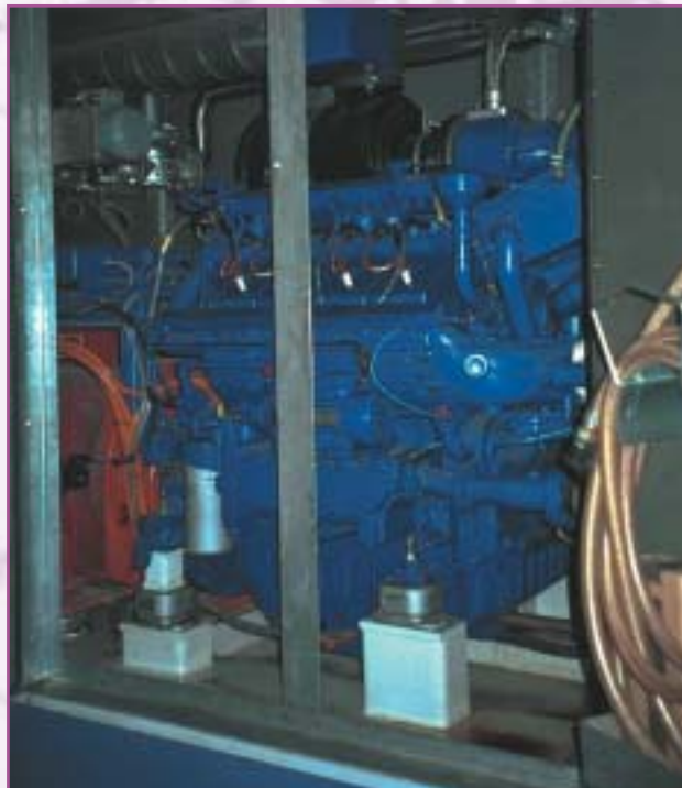
Motor de la cogeneración de la EDAR de Huesca
