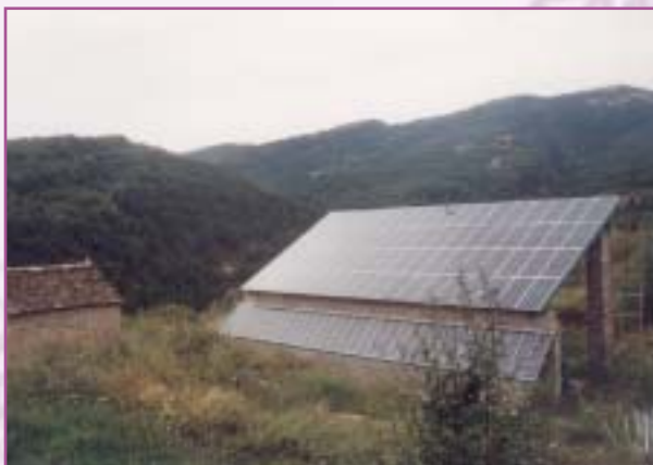
Instalación Solar Fotovoltaica en Artosilla (HUESCA)
