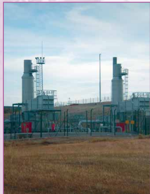
Estación de compresión de gas natural en Cuarte (Zaragoza).
