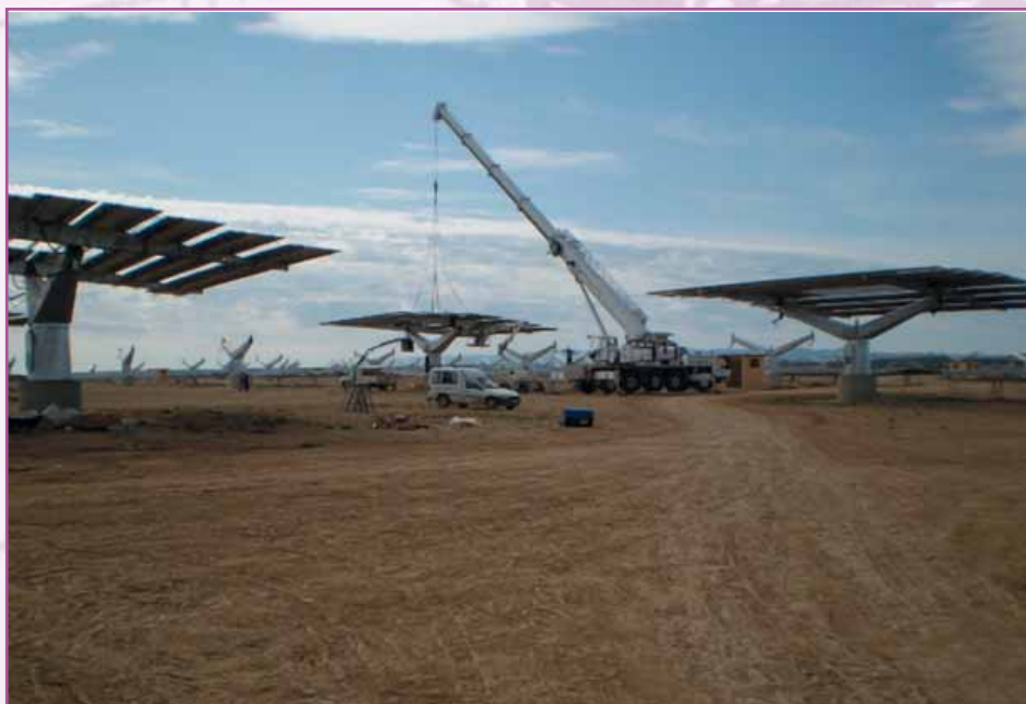
Instalación solar de 2,86 MW. Ejea de los Caballeros (Zaragoza).
