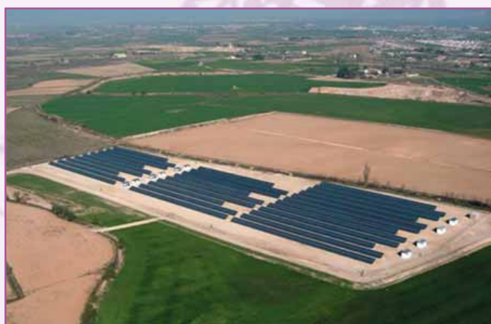
Instalación solar 1 MW. Garrapinillos (Zaragoza).
