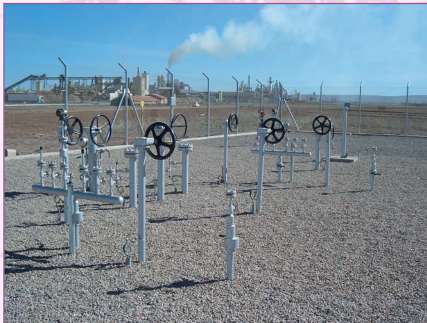
Campo de válvulas en gasoducto Cuencas Mineras
