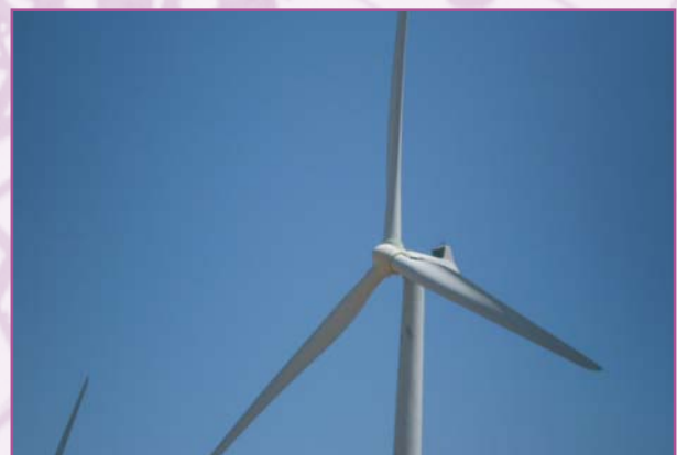
Parque Eólico en Belchite. 49,5 MW (Zaragoza)
