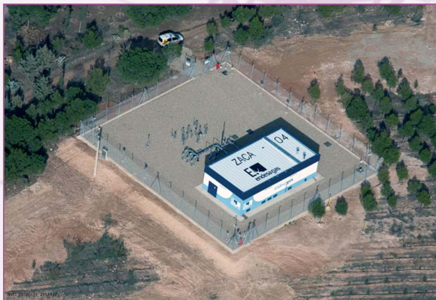
ERM en gasoducto Zaragoza-Calatayud. Posición ZACA-04 (La Almunia)
