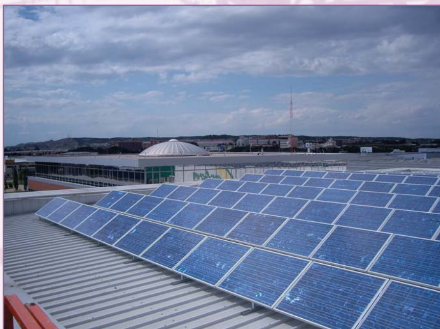
Instalación Solar Fotovoltaica de 100 kW sobre cubierta Transportes Ochoa (Zaragoza)
