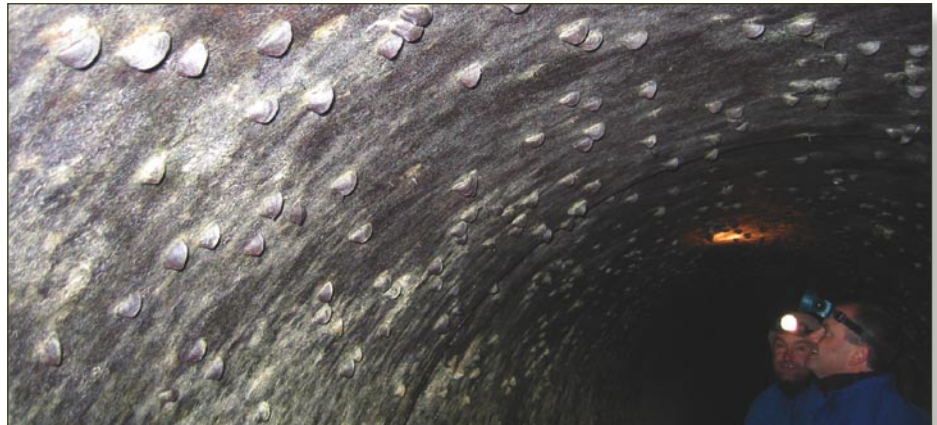
Foto 3: Mejillones adheridos en el interior de una tubería de 130 cm de diámetro
