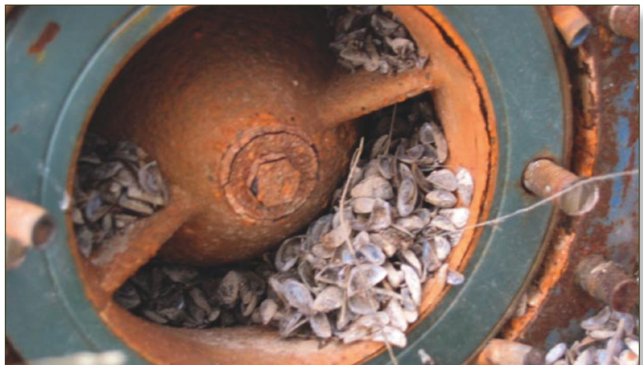
Foto 1: Bomba de impulsión averiada en la que se observa la presencia de numerosas valvas en su interior
