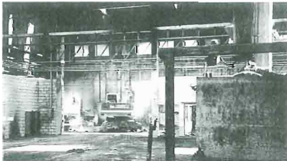
Interior de la incendiada fábrica de Tubos Ecopol.
