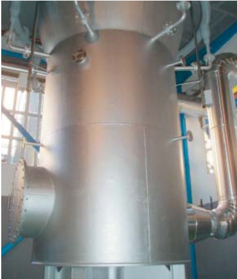
La previsión es que en Aragón se incorporen otras tecnologías como la gasificación de la biomasa.
