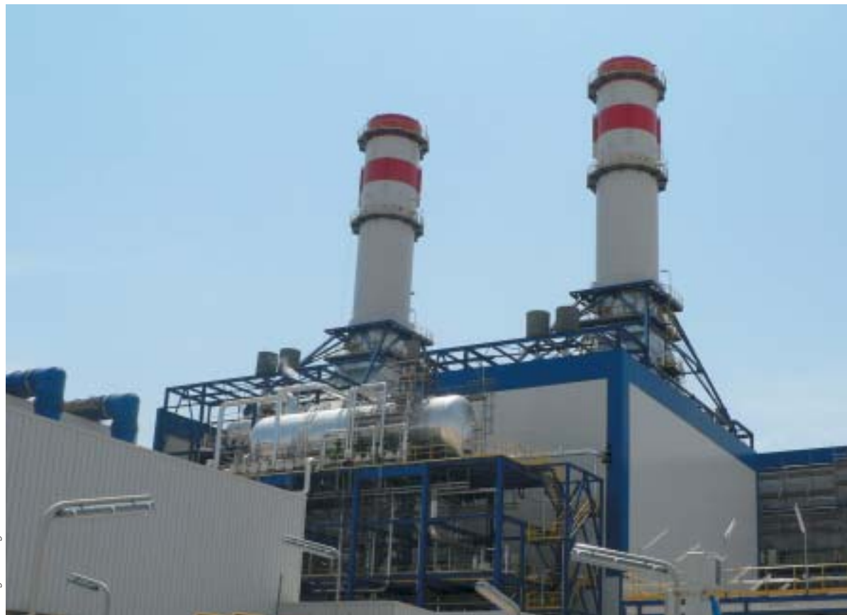
Recientemente, ha entrado en funcionamiento un ciclo combinado en el término municipal de Castelnou, en Teruel, con una potencia eléctrica de 800 megavatios.
