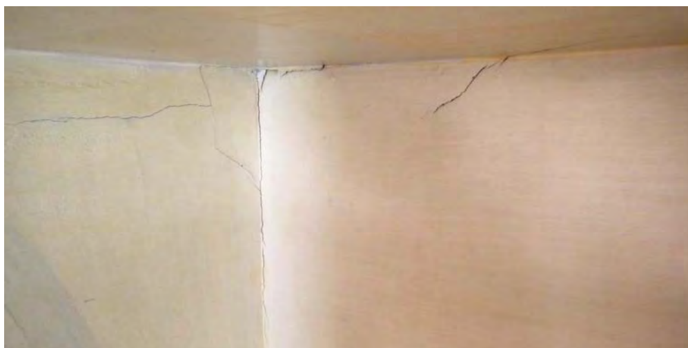
Grietas en los frisos sureste y suroeste
