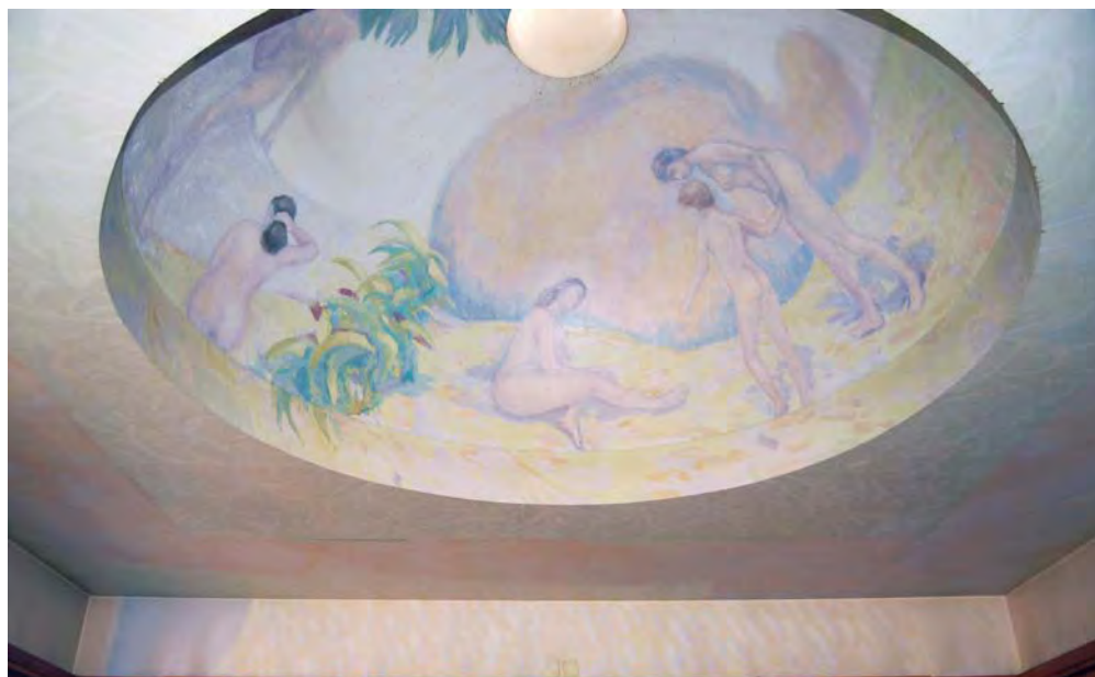
Estado inicial de la cúpula y techo pintados por Eduardo Salavera
