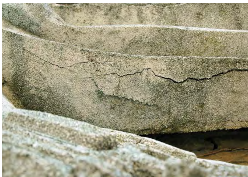
Detalle de las grietas y fisuras causadas por la oxidación de la estructura interna metálica
