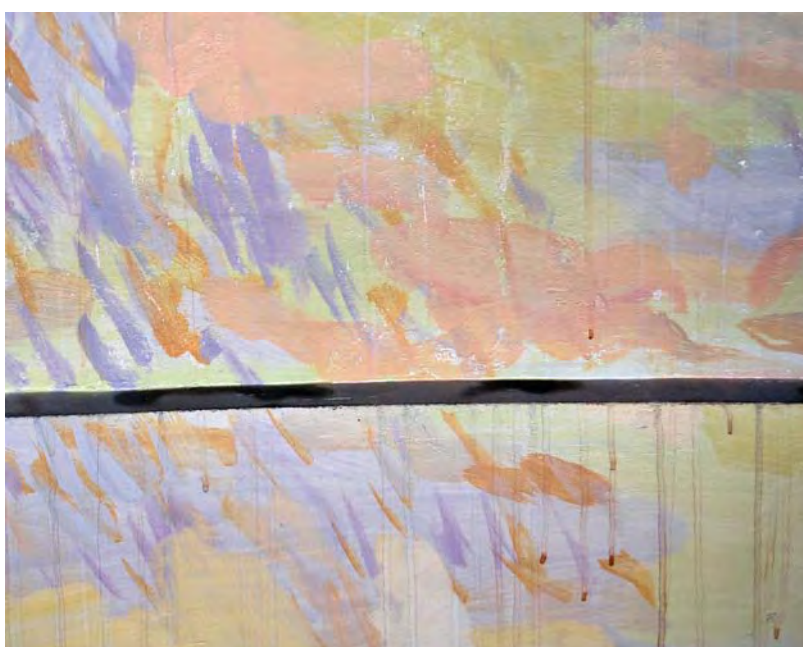
Detalle de la acumulación de polvo y las escorrentías en la cornisa
