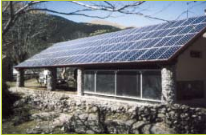
Energía Solar Fotovoltaica centralizada en Escuaín (Huesca)
