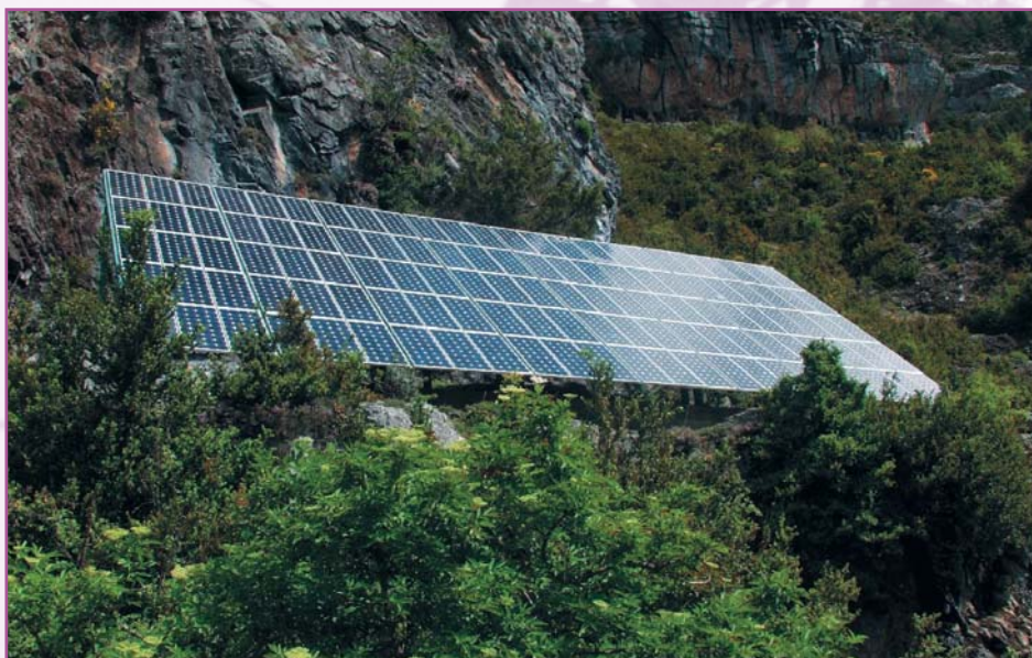
Energía solar fotovoltaica en Revilla
