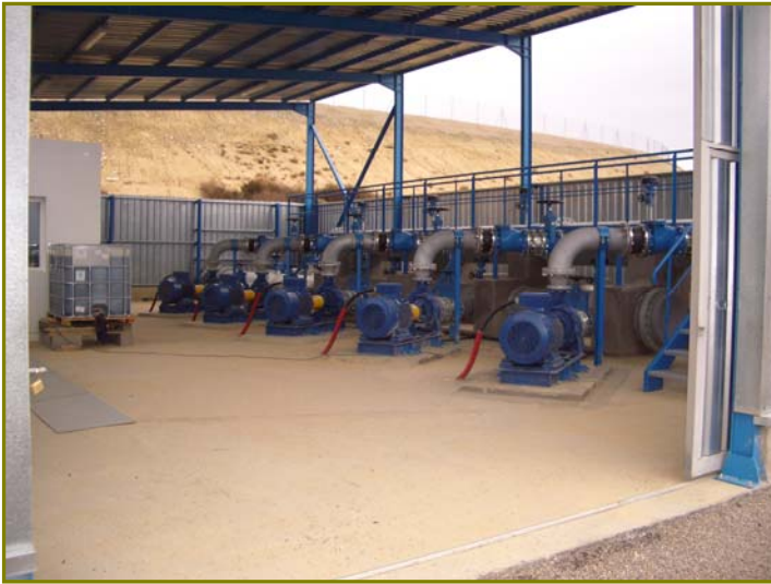
Foto 2. Estación de bombeo Sector XXI Castellflorite. Bombeo directo. Cinco bombas, una con variador.
