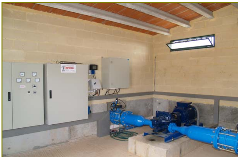
Foto 1. Bombeo directo, bomba con variador en la Comunidad de Regantes de Aniñón. Campo de trabajo: 5 a 45 litros/segundo.
