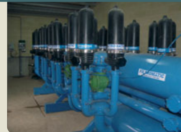
Sistema de filtrado automático con anillas
