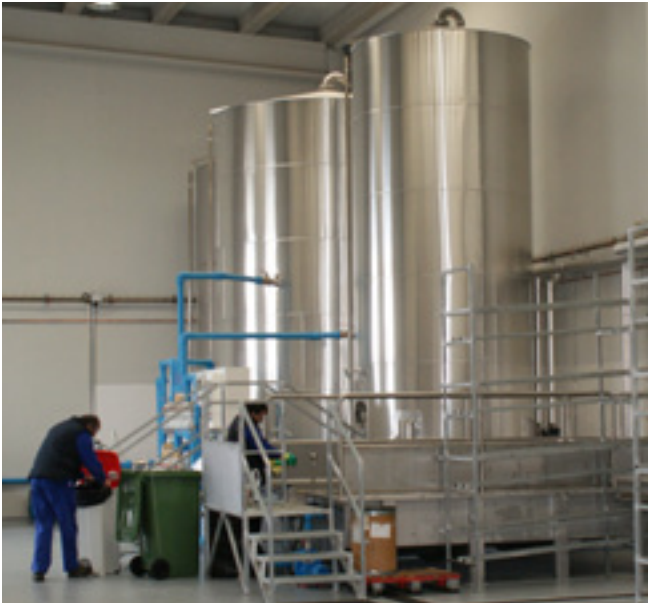
Planta de tratamiento del aceite usado recogido por los trabajadores del proyecto ECODIS.
