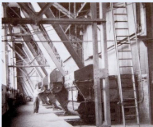
Sala de calderas (1946)
