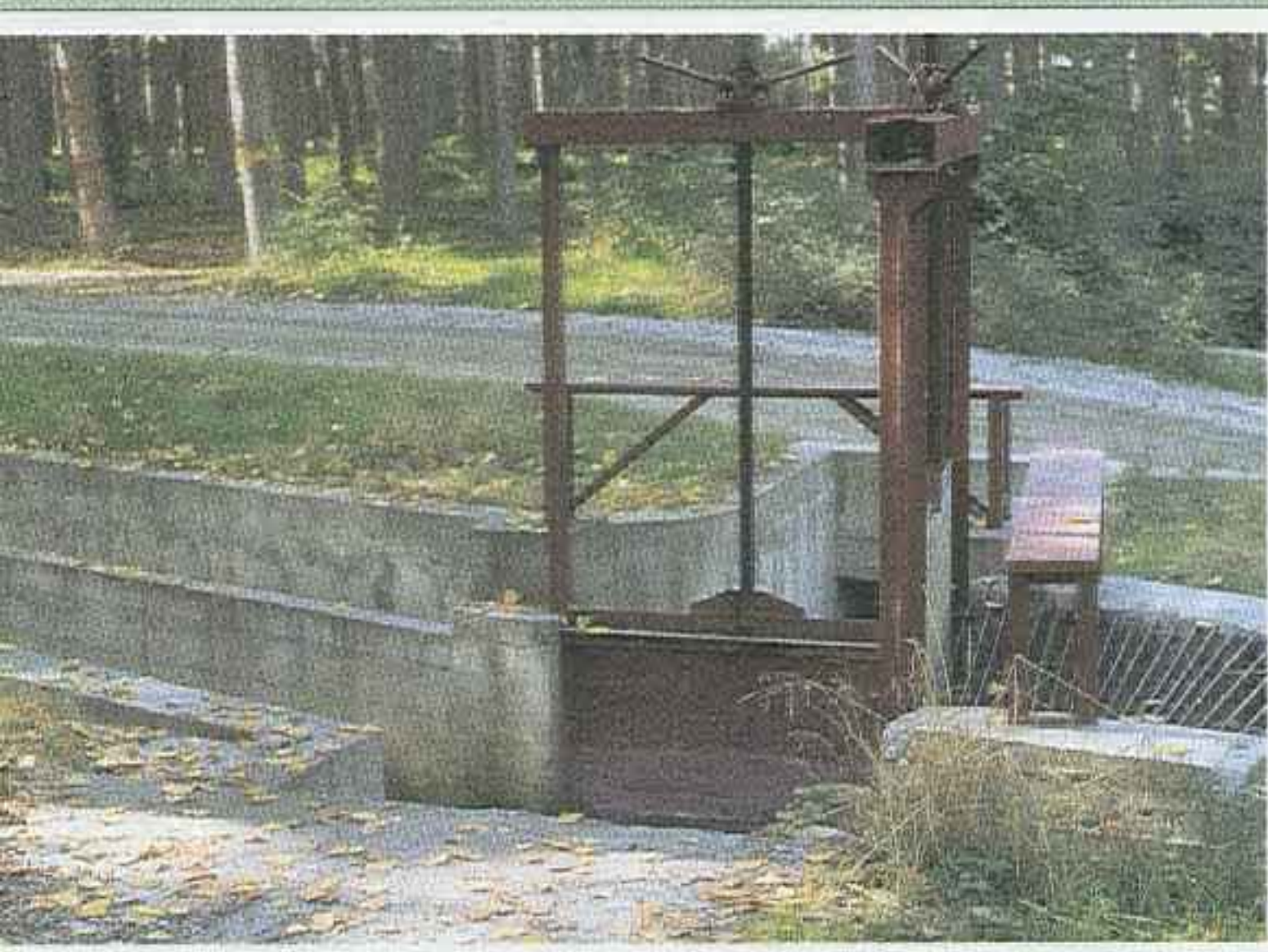
Capacidad. Los filtros verdes tratan agua de 25.000 habitantes.
