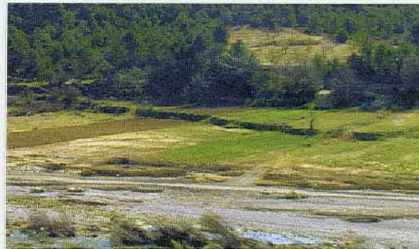
En recuperación. Una vista de los trabajos de reparación de la cuenca del río Matarraña.
