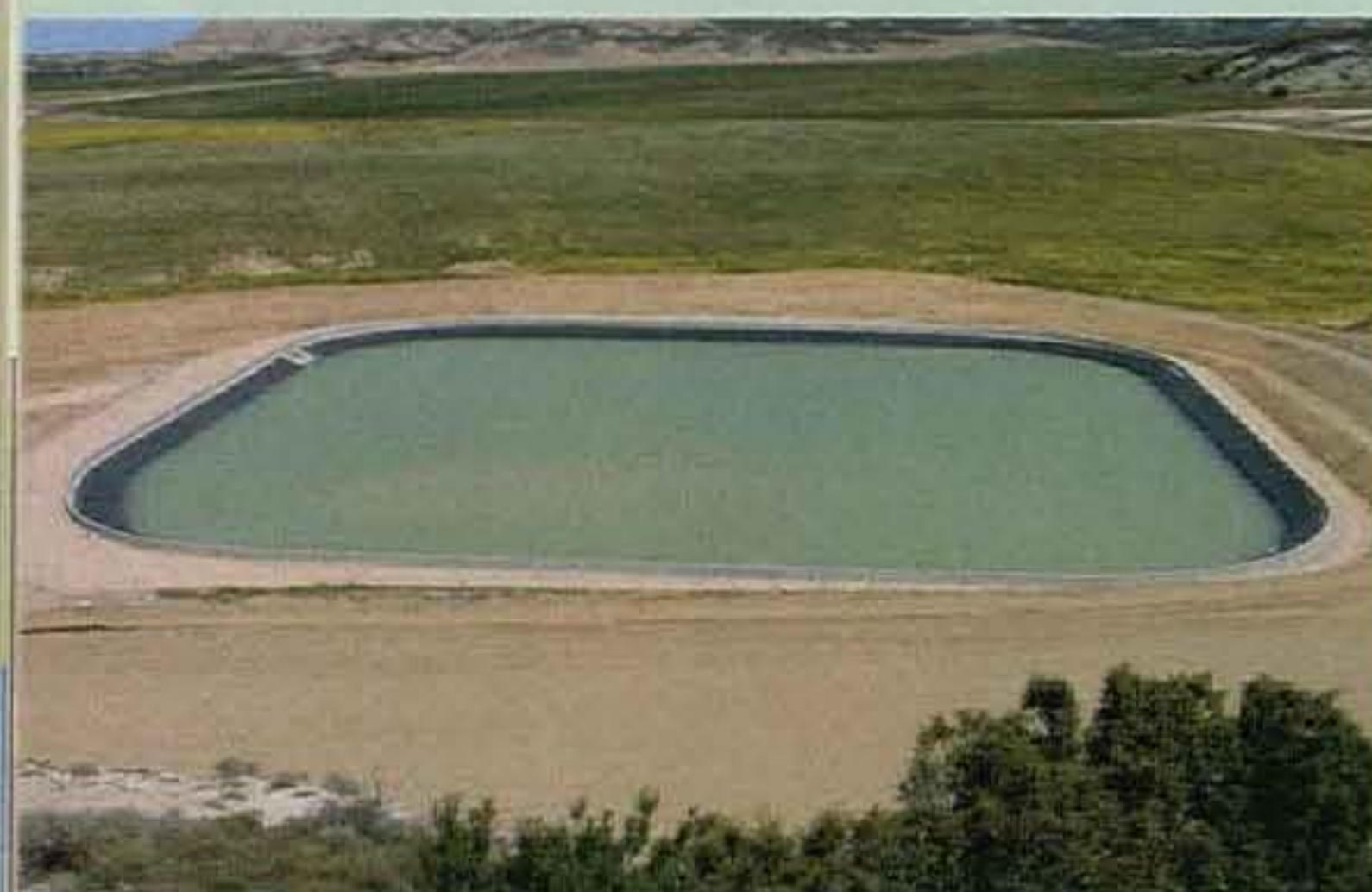
La foto muestra las obras del sector XIV de Bardenas II, en Tauste (Zaragoza).
