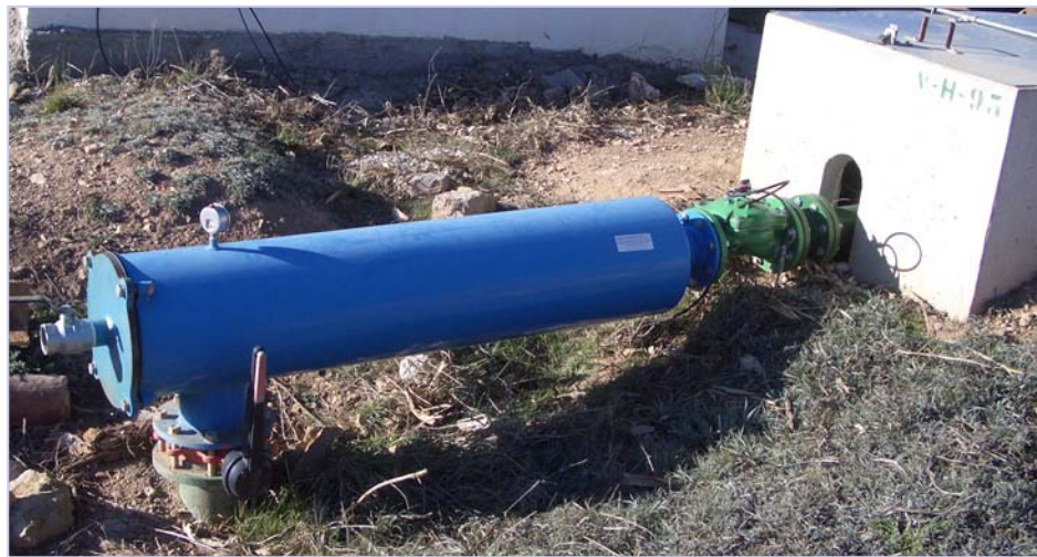
Foto(4): Cabezal de entrada con válvula maestra
