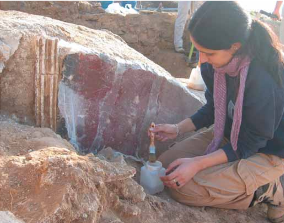
Fig. 3. Detalle de los trabajos de consolidación de la pintura mural aparecida in situ en el espacio 13 (posible larario)
