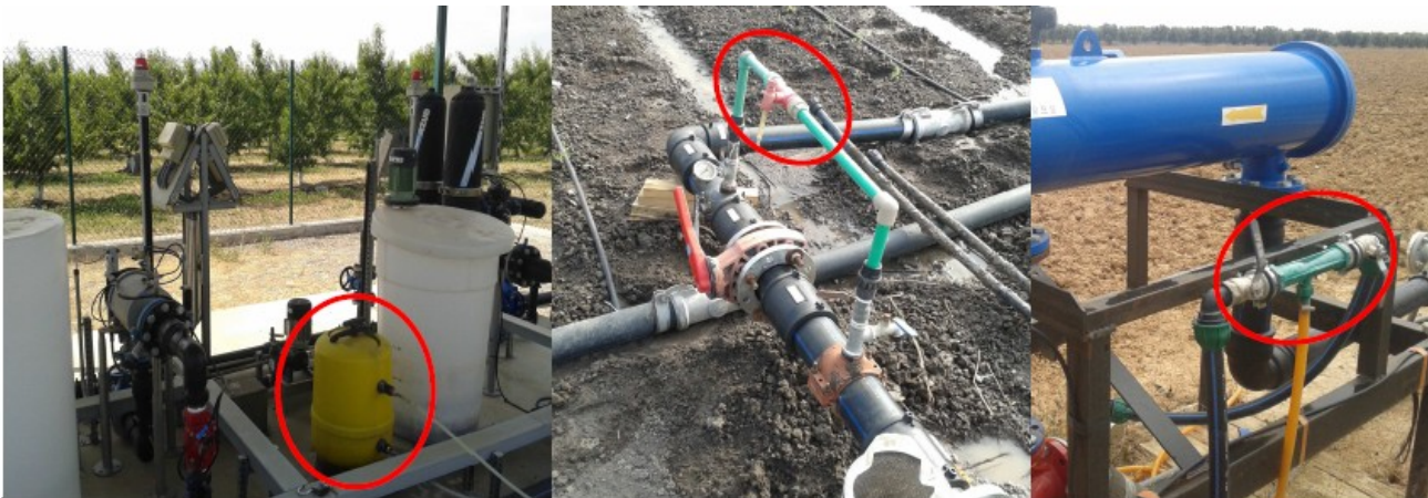
Tanque fertilizante y venturis. Ambos sistemas necesitan, para su funcionamiento, que se provoque una pérdida de presión en la red mediante un bypass.
