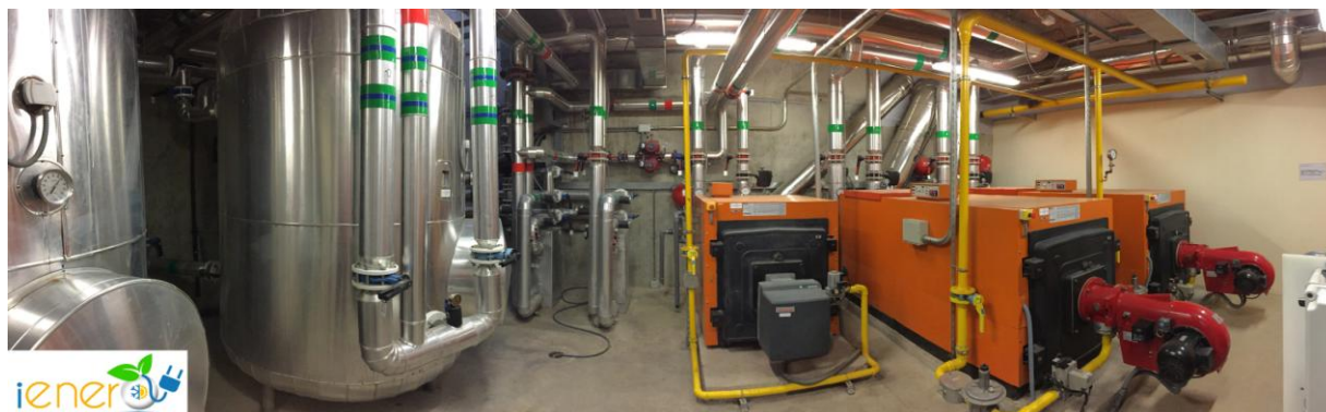
Central térmica del HSJD.
