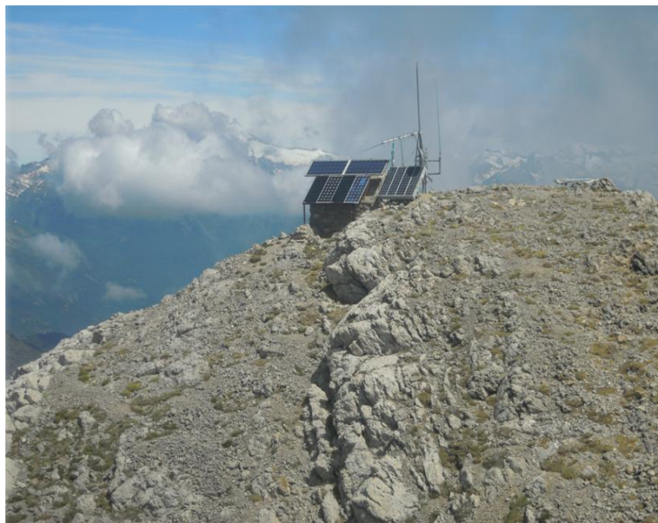
Estación de energía Solar Fotovoltaica para repetidor en el Turbón (Huesca)
