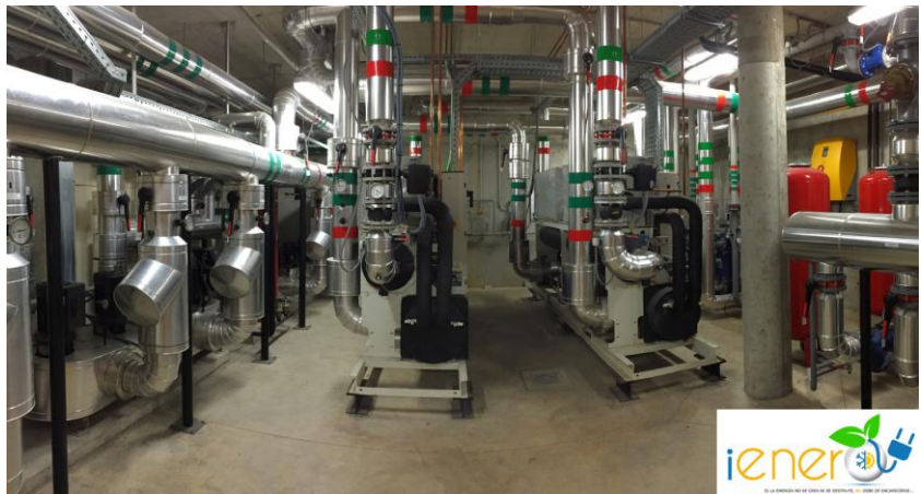
Enfriadoras/bombas de calor geotérmicas del HSJD.
