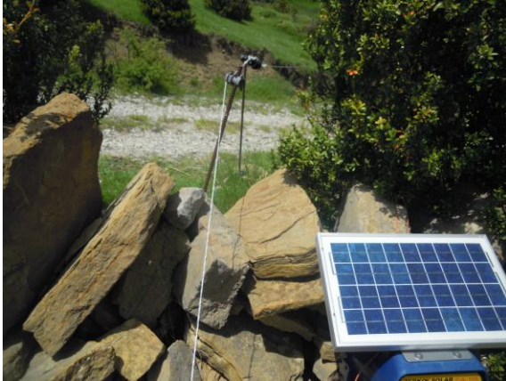
Instalación fotovoltaica para cuidado de ganado (Huesca)
