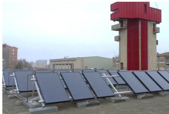
Instalación solar térmica en parque de bomberos N° 1 (Zaragoza)
