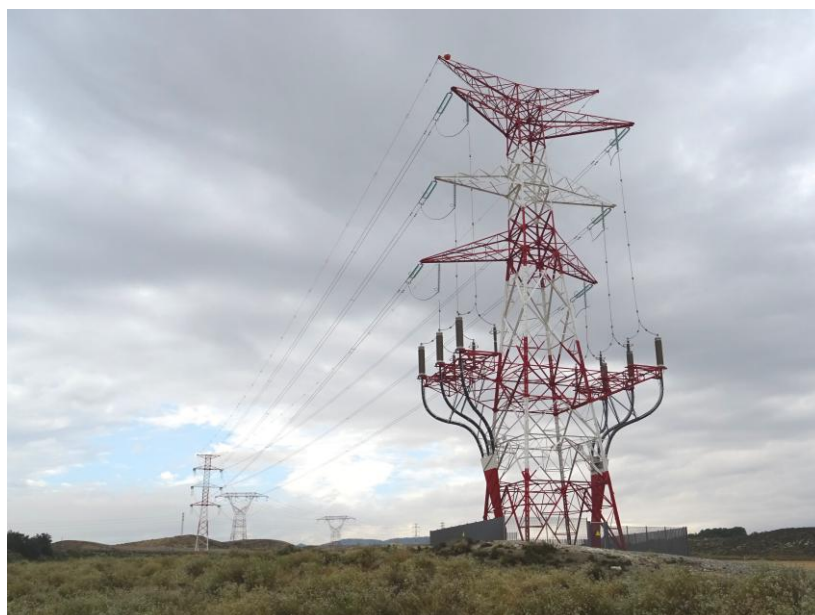
Línea 220 kV de entrada y salida a PLAZA de la L/ Entrerrios – Montetorrero (Zaragoza).
