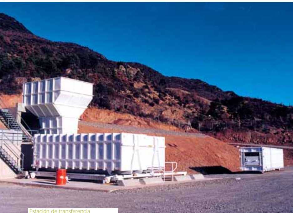
Estación de transferencia de Sabinánigo
