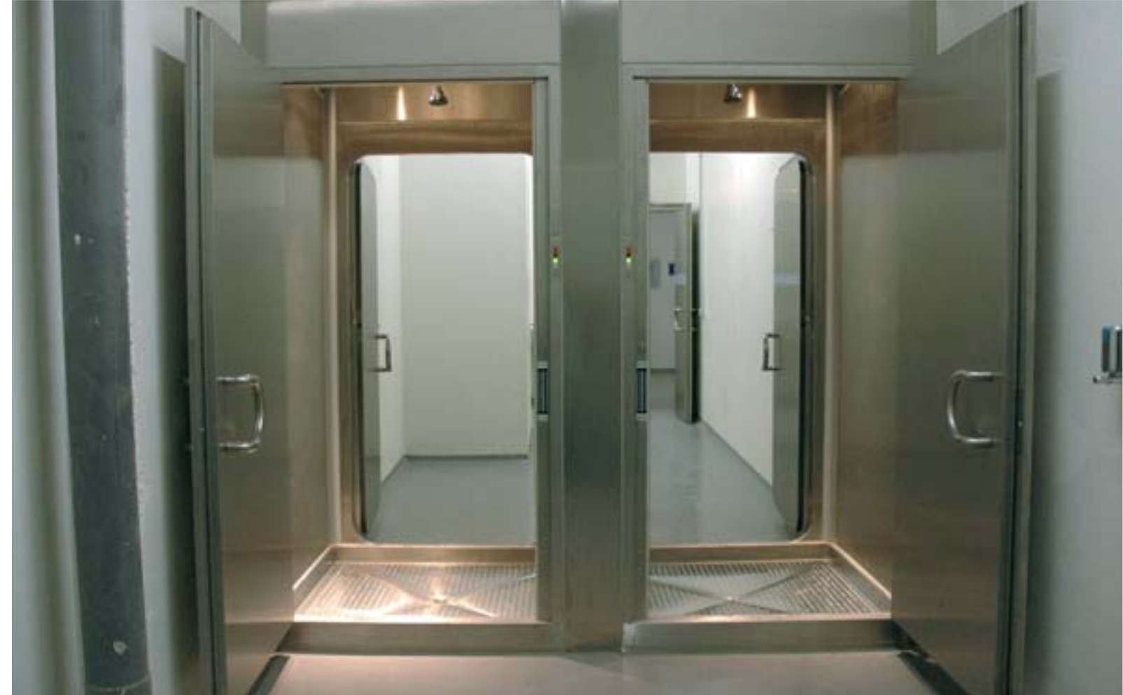
Puertas de acceso de seguridad al laboratorio P3
